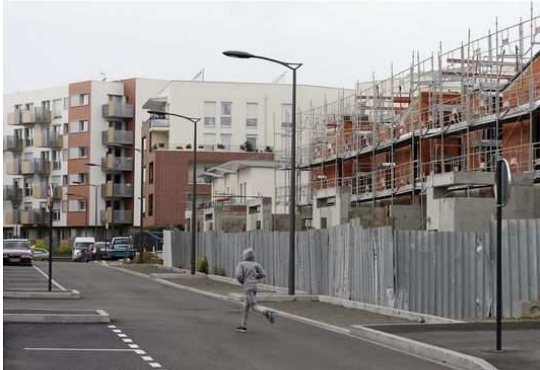
Des appartements en construction à Clichy-sous-Bois, dans la banlieue parisienne, en mai 2014. ALAIN JOCARD / AFP
